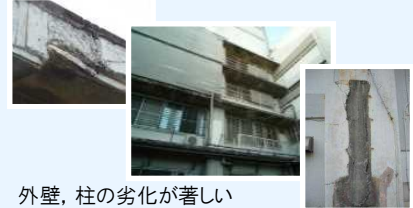
外壁，柱の劣化が著しい
