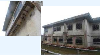
収容棟壁面の劣化が著しい
