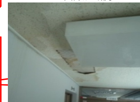
天井から漏水
