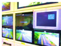
監視システム
