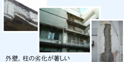
外壁，柱の劣化が著しい
