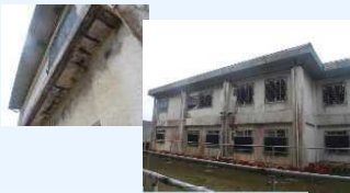
収容棟壁面の劣化が著しい
