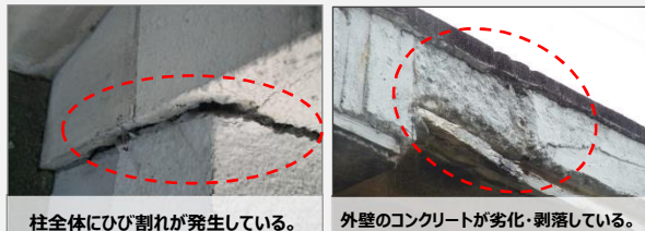
柱全体にひび割れが発生している。
