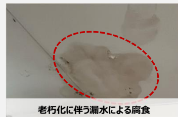
老朽化に伴う漏水による腐食
