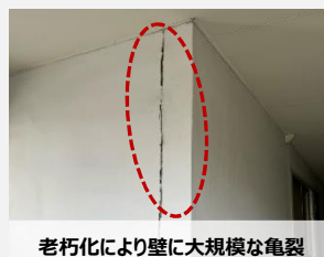
老朽化により壁に大規模な亀裂
