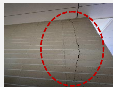
老朽化により壁に大規模な亀裂
