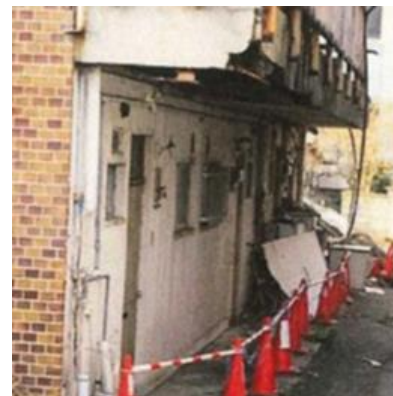
外壁剥落等の危険な状態
